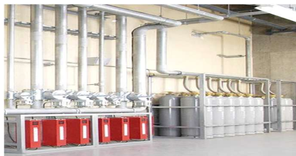
• ガス消火設備
